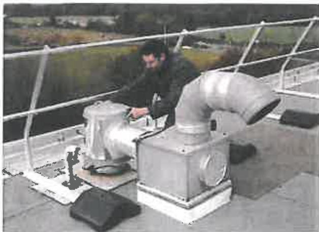
Wartung und Pflege von technischen Anlagen – jederzeit ohne Risiko.
